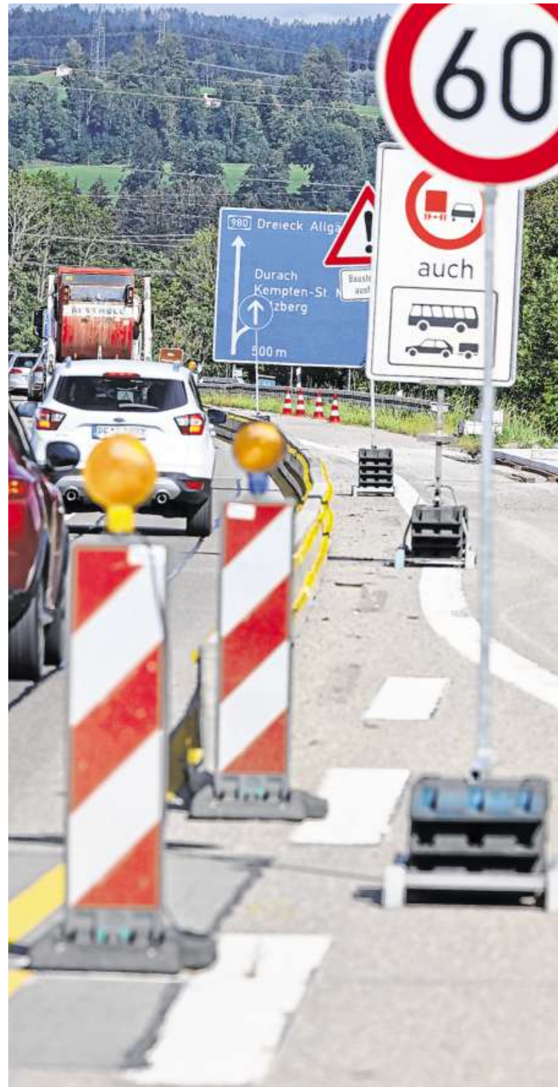
Nur Tempo 60 oder 80 darf im Bereich der Baustelle gefahren werden. Die Polizei sagt: „Es kann immer zu Kontrollen kommen.“
